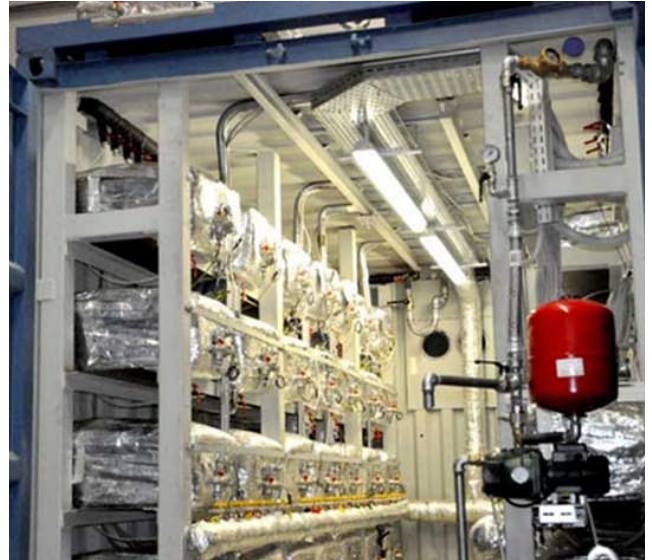
1-MW-Heisanlage im Container der Grösse von 2,4 m * 2,6 m * 5 m mit parallel geschalteten E-Cat-Reaktoren.
