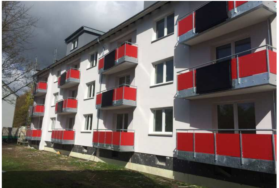
Bei einem Sanierungsprojekt in Delmenhorst wurden im Mai 2016 mehrere PV-Module für Balkone verbaut und Micro-Wechselrichter der Firma AEconversion GmbH verwendet.
