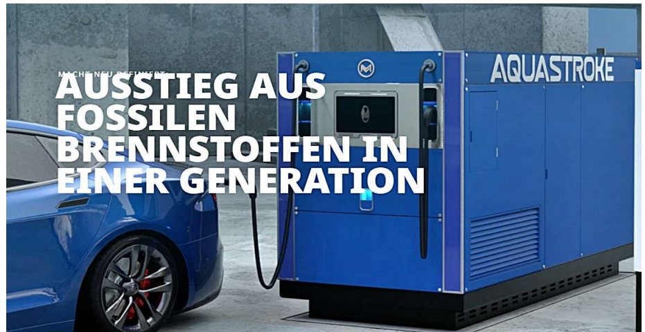
Elektrische Ladestation “Generator-zu-Auto-Technologie” mit einem Stromaggregat, dessen Motor mit 70% Wasser und 30% Ethanol betrieben wird.
