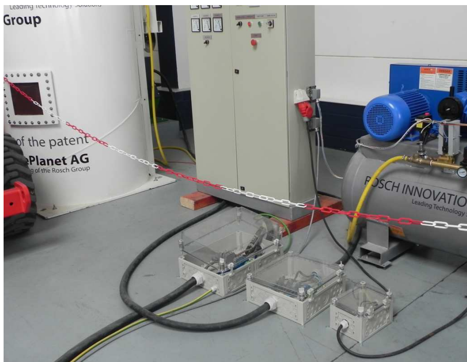
Anschlusskasten (links Mitte) mit Leitungen vom Steuerungskasten zur Heizungsanlage (linkes Bild), Anschlusskasten (Mitte) mit Leitungen direkt vom Generator zum Steuerungskasten, Anschlusskasten (rechts) mit Leitungen zum Kompressor.
