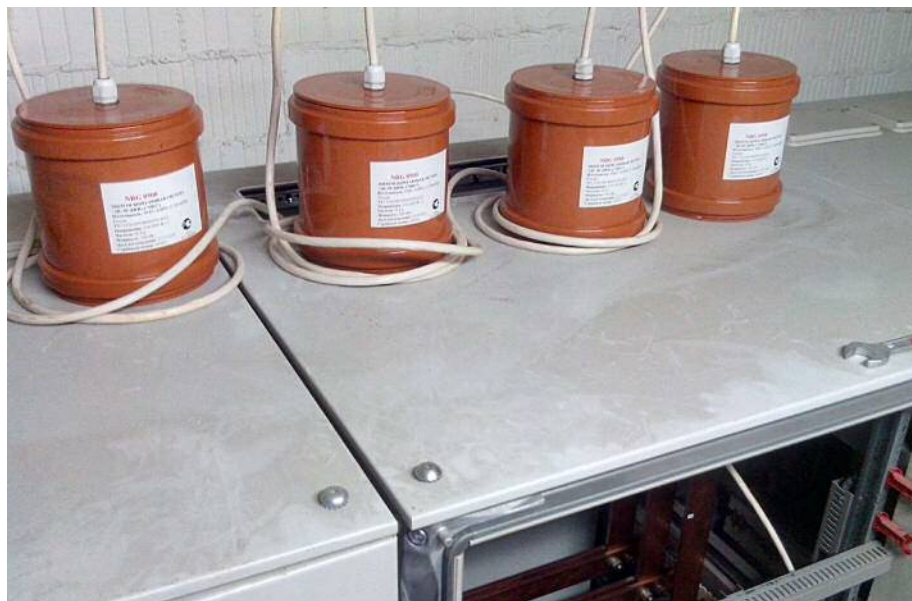
Vier Töpfe mit chemischem Verbundmaterial, das bei Anschluss an ein Wechselspannungspotenzial Überschuss-Elektronen abgibt. Diese sind angeschlossen an die einzelnen Phasen in einem elektrischen Schaltschrank eines Supermarkts.
