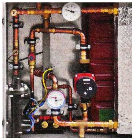
Das N-Tech-Heizsystem mit einer Ionisationskartusche für 10 kW.
