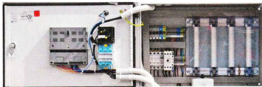
Der geöffnete Steuerungskasten mit vier Energieoptimierer-Röhren des N-Tec-Systems.
